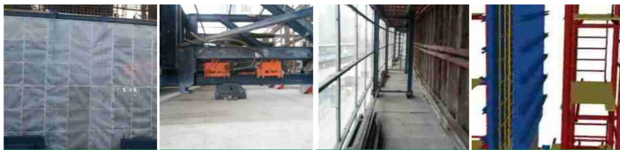
■ 安装防护网片 Installation of Protective Net ■ 安装液压电气系统 Installation of Hydraulic System ■ 安装模板 Installation of Formwork ■ 安装完成, 合模打灰 Mount the Formwork
